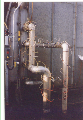
INJECTOR UNITS AT THE DU PONT SITE
